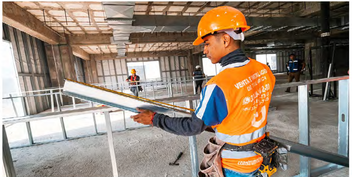
Sótano, planta baja y primer nivel cuentan con ocho frentes de trabajo en esta obra de más de 49 mil metros cuadrados. ESPECIAL
