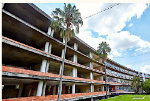
■ En uno de los edificios del complejo educativo la renovación está detenida debido a la falta de permisos.
